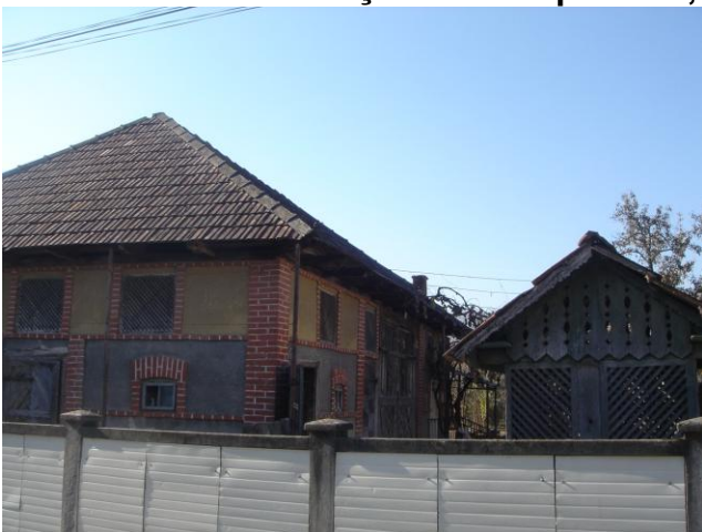
Imaginea spre stradă este evident alterată de placajul de plastic aplicat pe gard.
