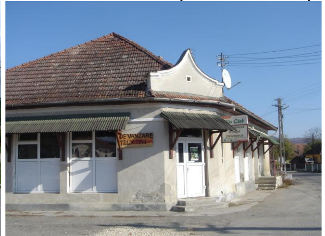
Spațiu comercial central, timplăria albă din plastic și copertinele cu azbociment realizate ulterior sunt total inadecvate.
